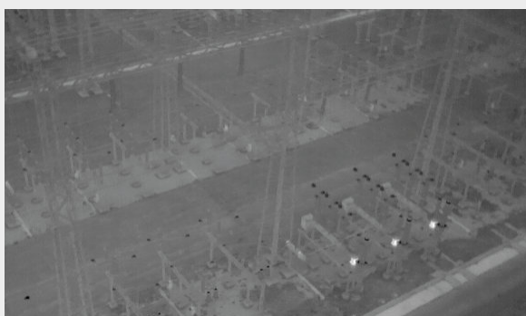
Übersicht-Wärmebild einer Unterstation
