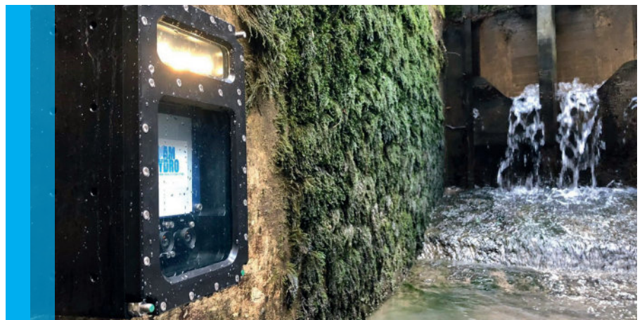
Die installierte I AM HydroCAM
