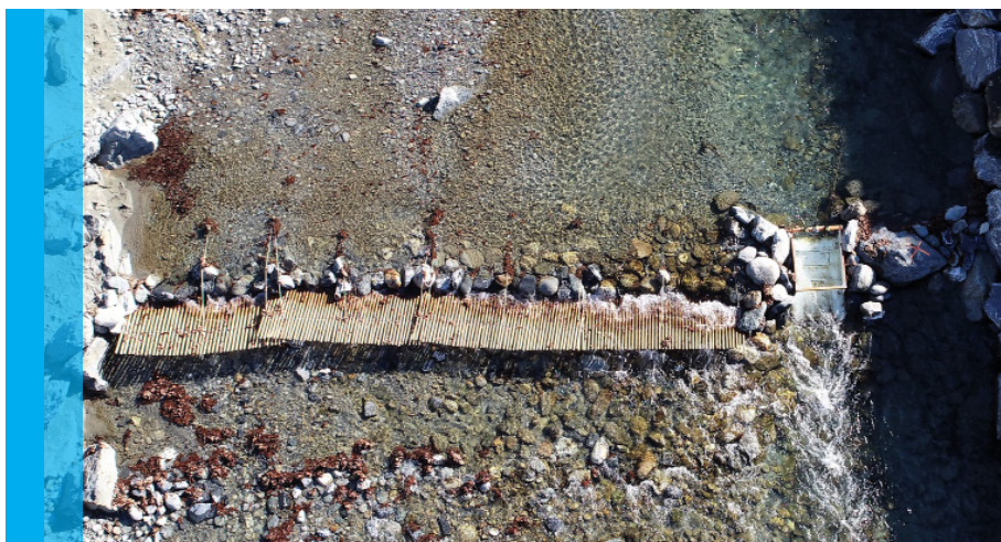
Die Fischzählanlage im Gadmerwasser
