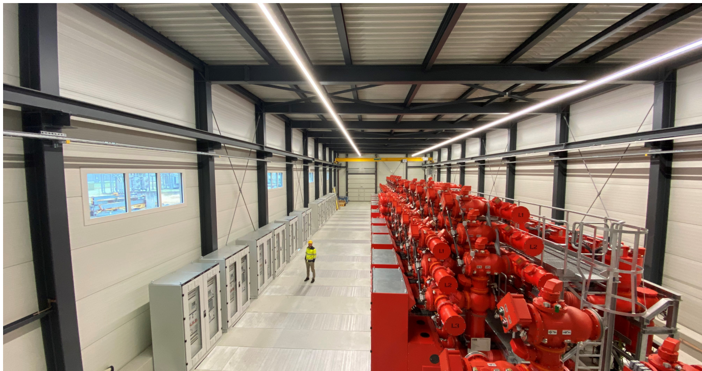
Der Projektleiter Thomas Heiniger im neuen 220 kV-Unterwerk in Innertkirchen
